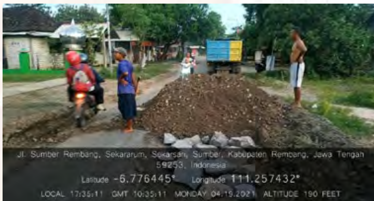
CSR Rembang : Bantuan Urugan bestcost Jl Sumber Rembang, Sekararum 19-4-21 Overburden of Sumber Street, Rembang, Sekararum
